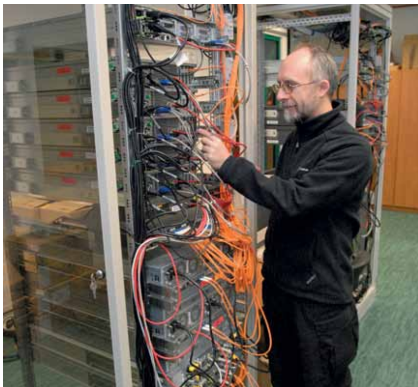
S. Sokół w głównej serwerowni UCI
